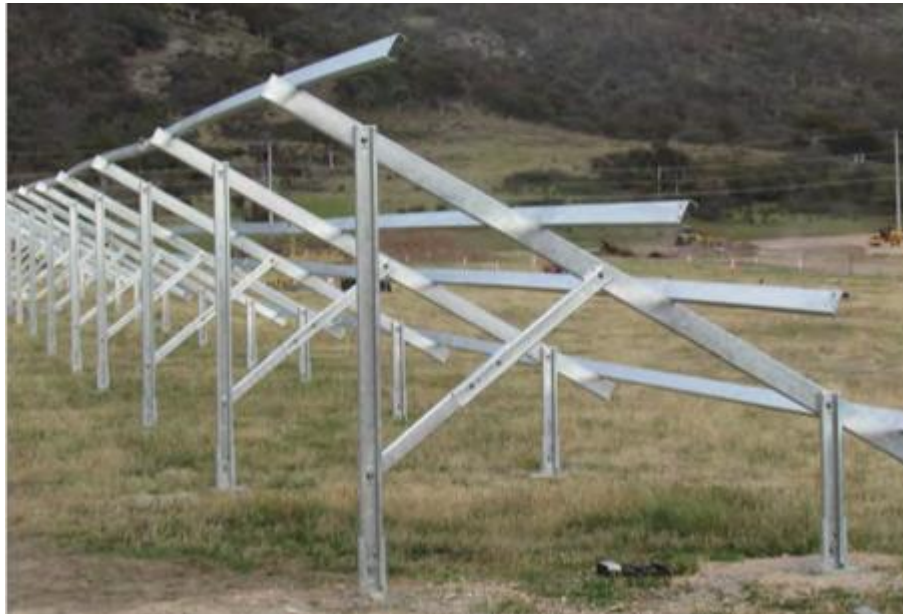
Εικόνα 5.7: Βάσεις στήριξης φωτοβολταϊκών πλαισίων
